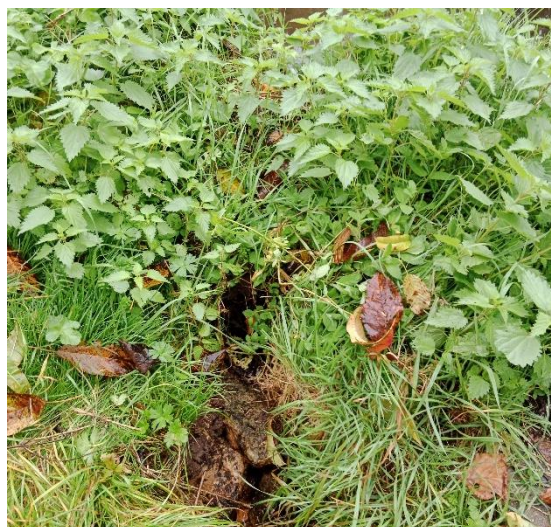
Photographies des renards hydrauliques prises lors d'une visite de terrain par les agents du SIARCE (23.10.2023)
